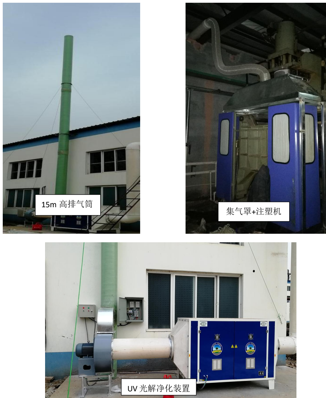
图3-2 非甲烷总烃治理设施图片
