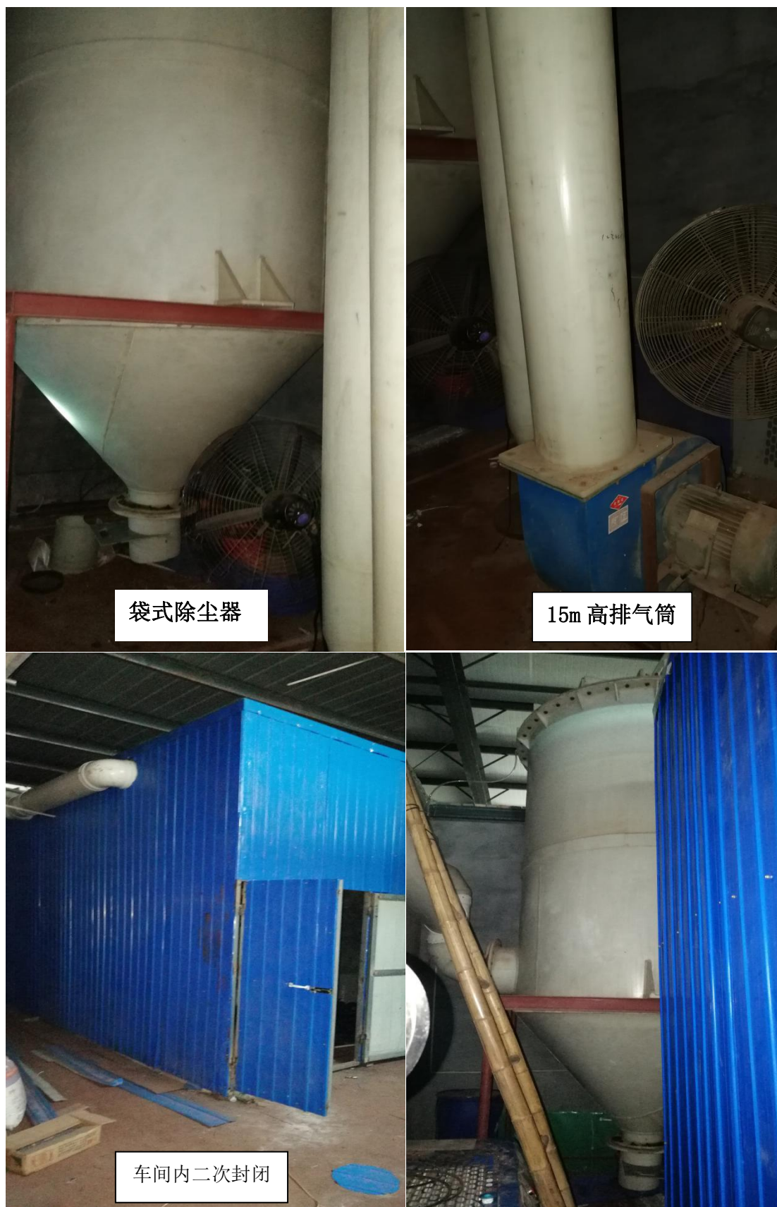
图3-1 粉尘治理设施图片
