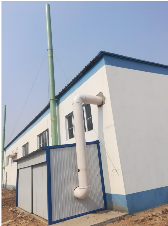
图 3-3 室外风机隔音间
